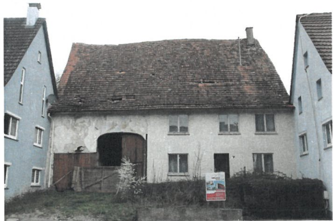
Abb. 11: Baufälliges Gebäude mit Einflugmöglichkeiten für Fledermäuse im Dach- und Scheunenbereich
